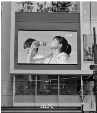
「アトレ恵比寿西館」に設置されたフルカラーLED大型ビジョン
