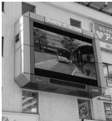
赤見電機が1997年に設置した小倉駅前の「グランライザ北九州」は20年以上経過した現在でも現役で稼働中
